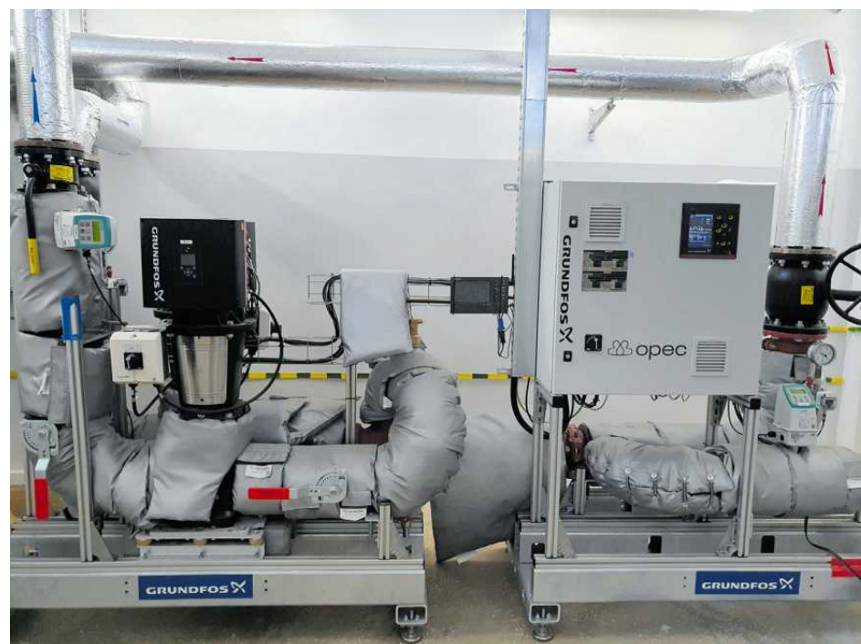
• Od kwietnia tego roku OPEC Gdynia korzysta z innowacyjnego urządzenia firmy Grundfos FOT. MATERIAŁY PRASOWE
